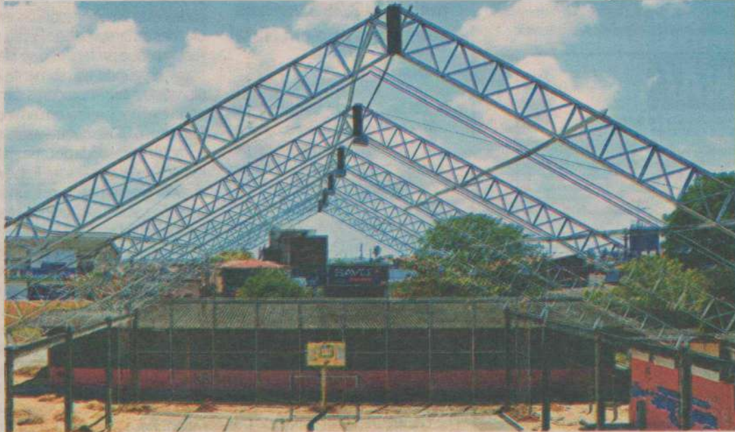
Quadra da escola Ivo Cavalcante está há sete anos sem teto e sem condições de uso pelos alunos. Situação que se repete
