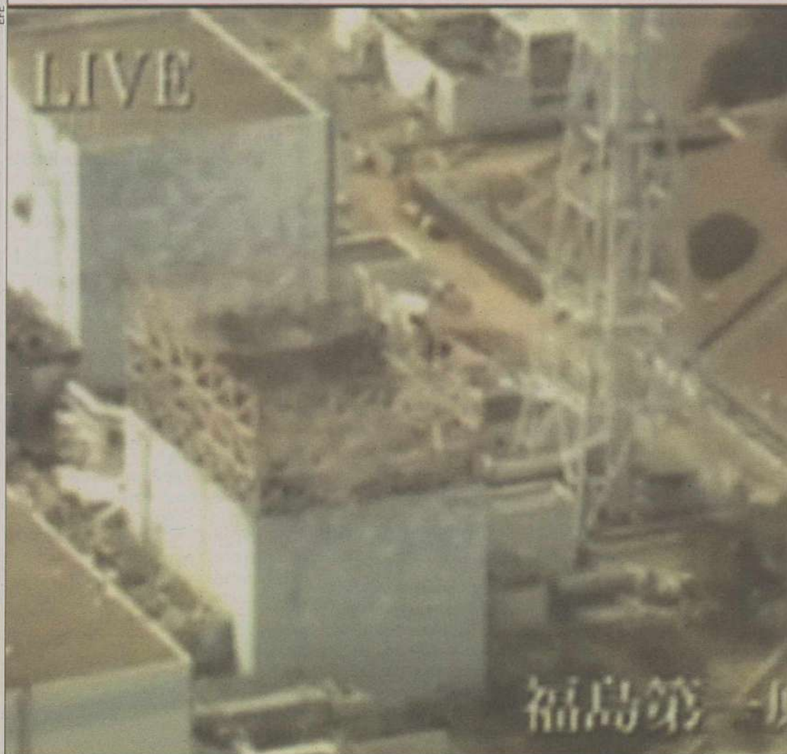
Drenagem da água que vaza do reator 3 é a prioridade para a equipe que trabalha no local
