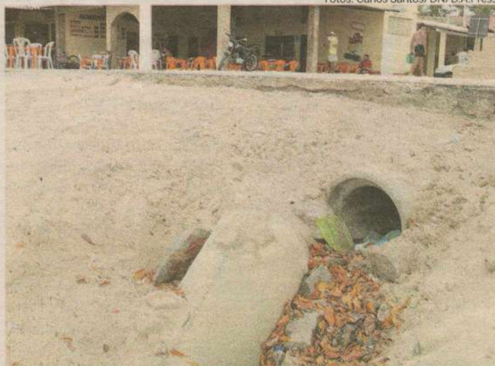
Praia tem cinco pontos onde jorra esgoto, segundo levantamento da Semurb
