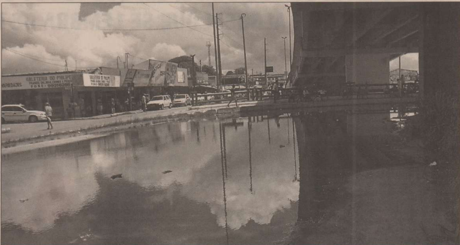
As chuvas também provocaram a formação de uma poça de água parada no túnel de passagem de pedestres, localizado no complexo viário de Igapó
